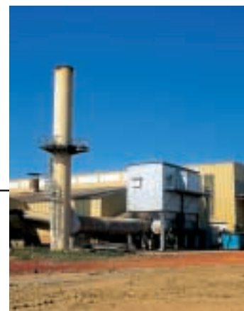
Purification des fumées
