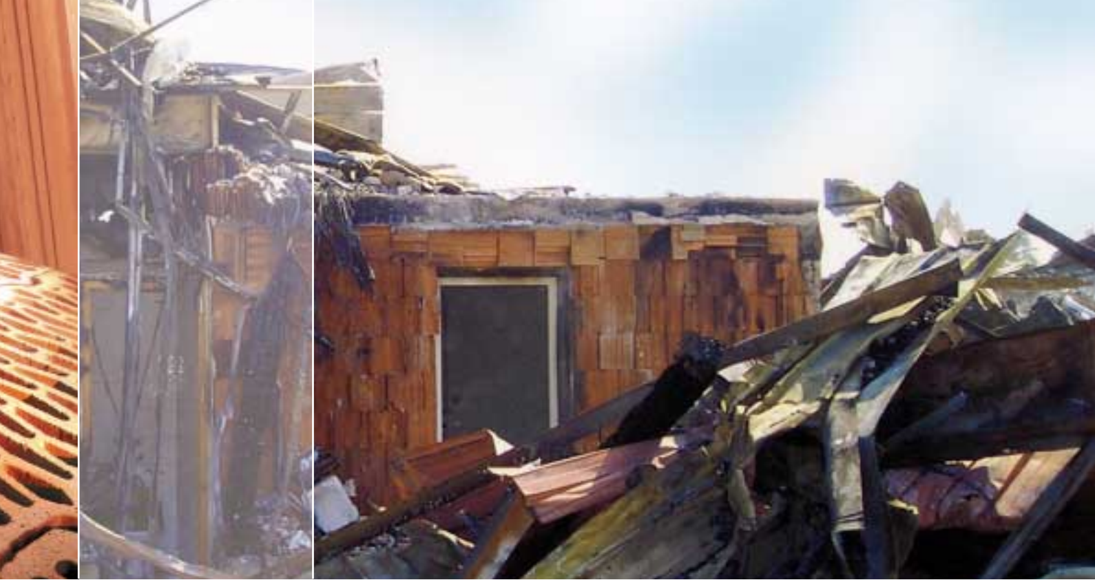
Après l'incendie d'un dépôt industriel de la région lyonnaise, seul le vestiaire, construit en Biomur Porotherm Roulé est resté intact à l'intérieur, résistant à des températures estimées à 1 000°C !
